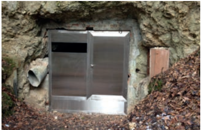
Abb. 1: Türe, die das alte Gipssteinwerk in Finges verschliesst. Einzig die Fledermäuse können hereinfliegen und ungestört überwintern.
