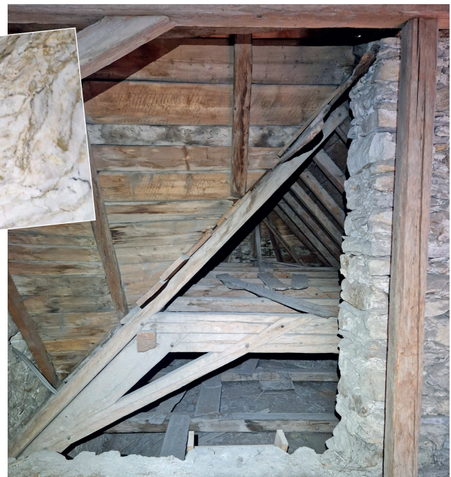
Fig. 2: Espace supérieur des combles du cœur de la chapelle Ringacker, avant l'aménagement. On a trouvé du guano d'une ancienne colonie de chauves-souris, ainsi que quelques crottes fraîches indiquant le passage récent de Rhinolophes.
